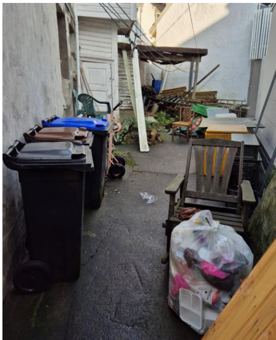
Figur 24: Eksempel på utvendig brennbar materiale mellom bygninger.
