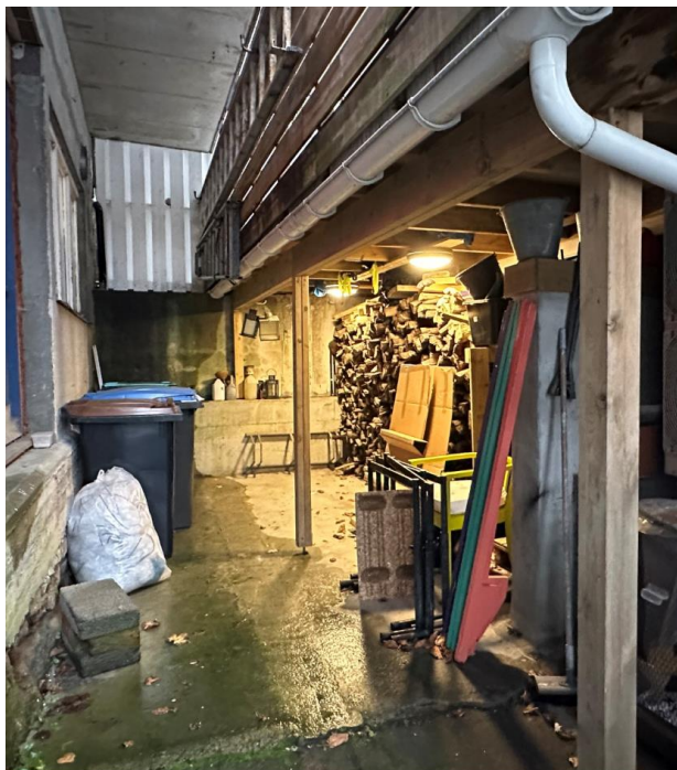
Figur 25: Eksempel på utvendig brennbar materiale mellom bygninger.
